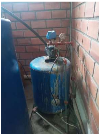
Figura 10. Sistema de bombeo de la finca "Bonanza"
